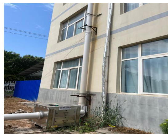
污水处理站废气活性炭吸附装置
