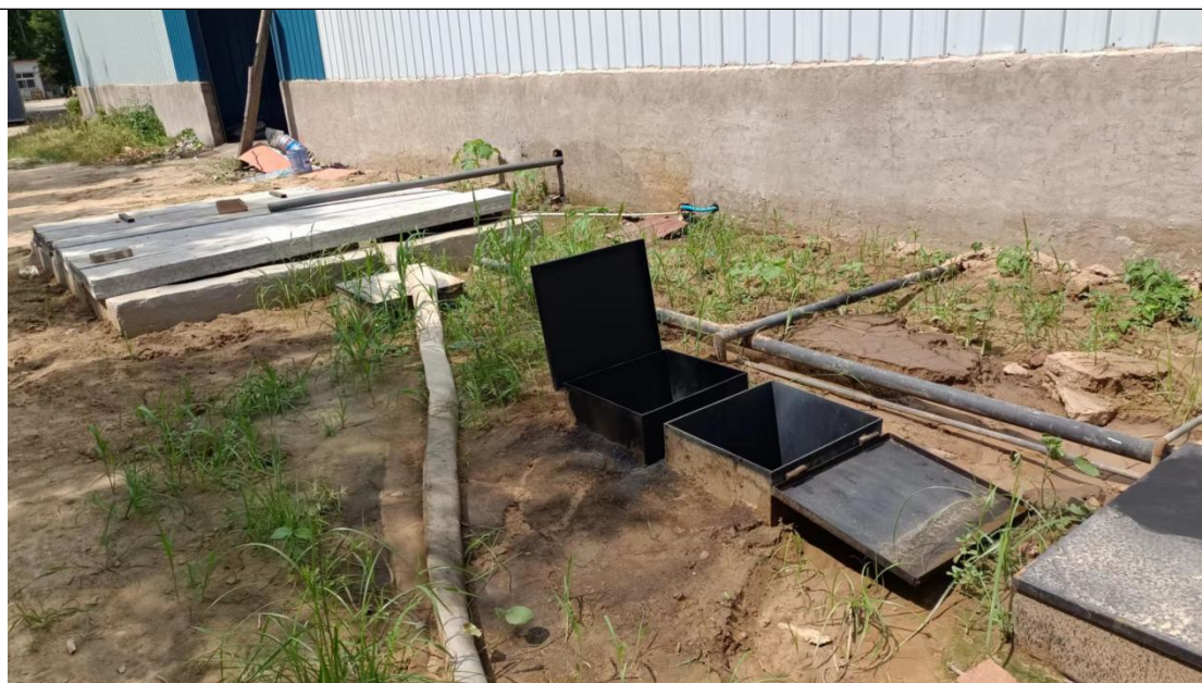
“反应沉淀+水解酸化+级接触氧化+二沉”地理式污水处理站
