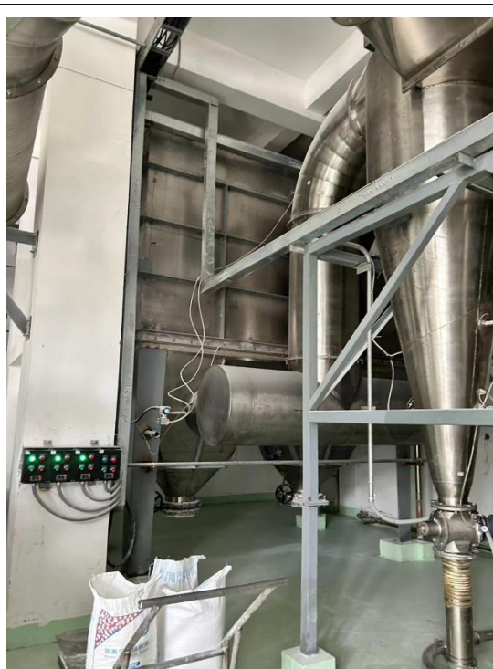
玉米芯线新增袋式除尘器
