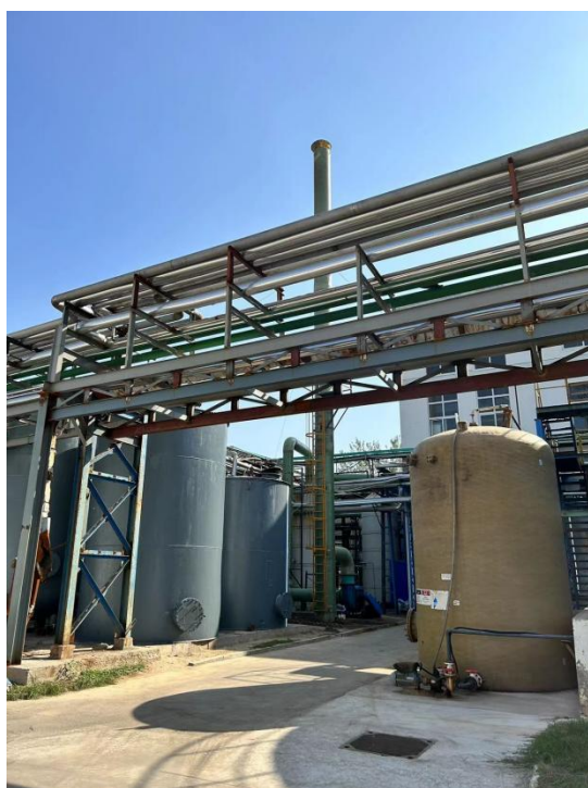
储存废气喷淋塔+排气管
