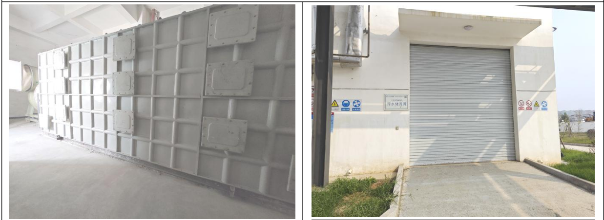
活性炭除臭装置
