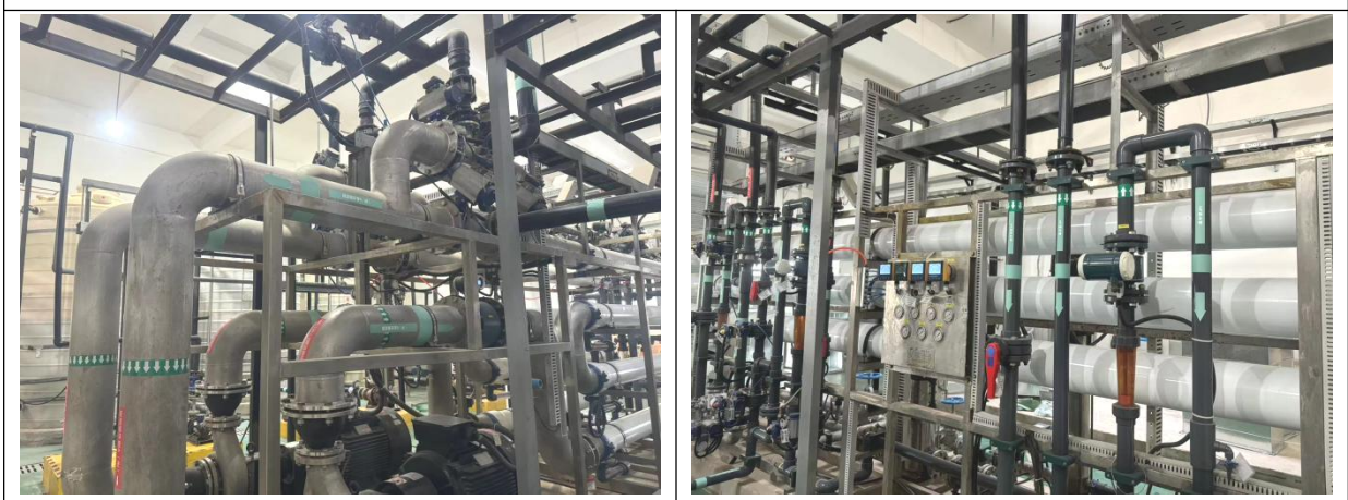
现场管道走向标识
