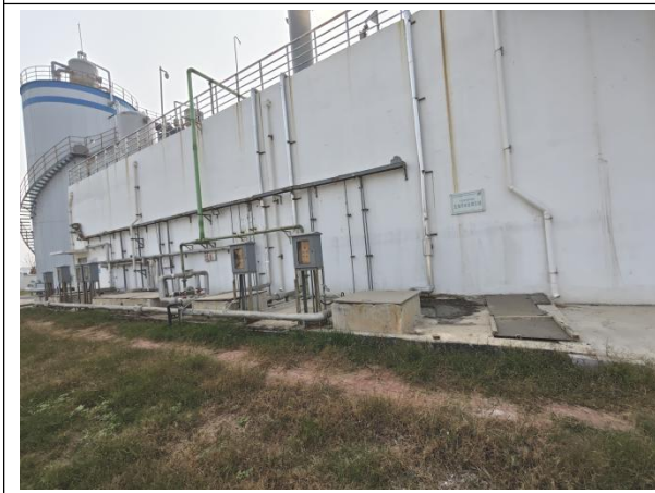
生活污水处理区域
